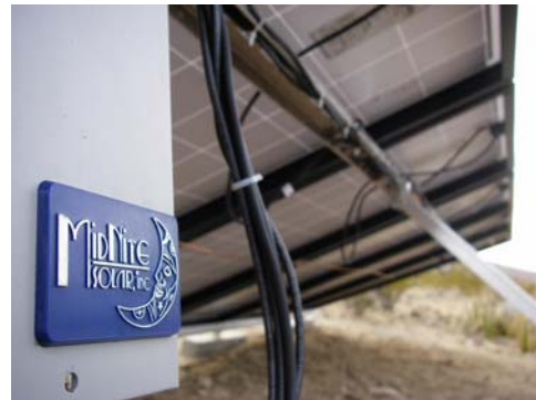
MNPV3 bottom conduit locations
